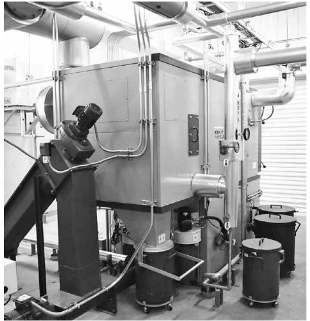
小学校に導入されたバイオマスボイラー
