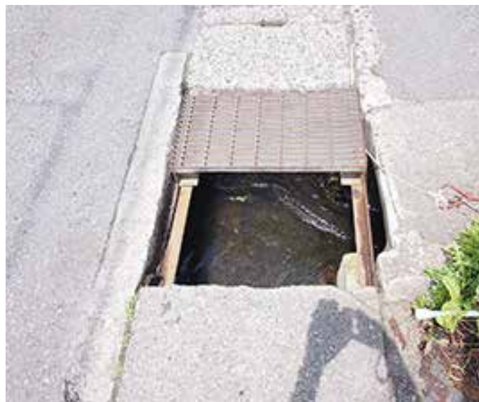
流雪溝の早期改修が望まれる
