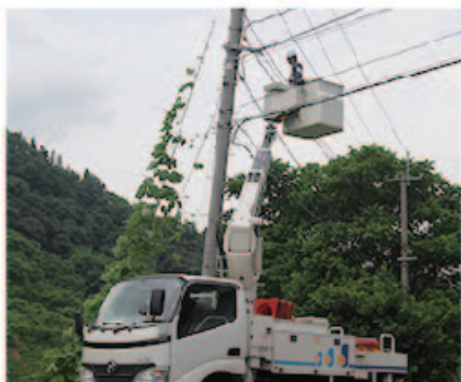
工事ミスがあったケーブルテレビ高度化第2期整備工事
