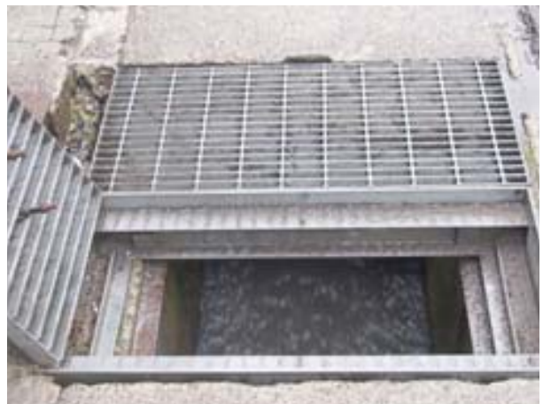
雪が詰まると水があふれる流雪溝
