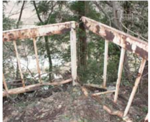
老朽化が進んでいる野沢小学校の川添いのフェンス
