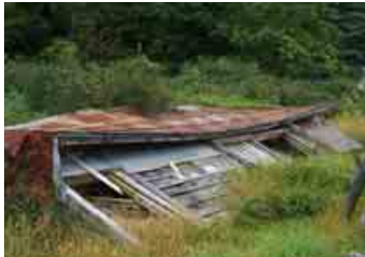
空家となり倒壊した家屋
