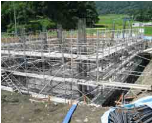
供用開始が待たれる野尻地区下水道処理場
