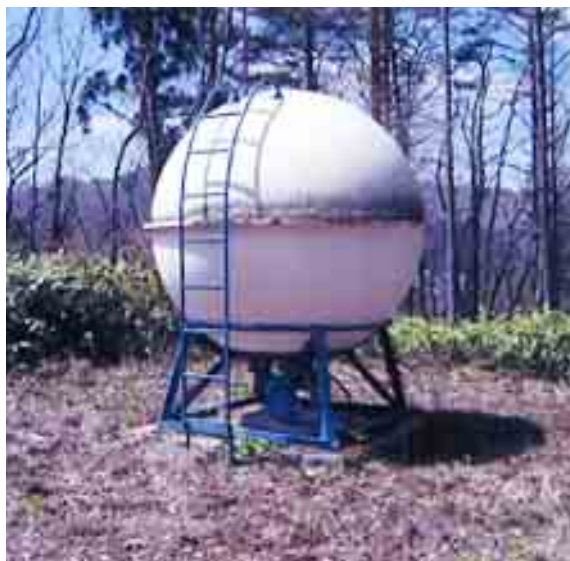
橋立自治区で整備した水道設備
