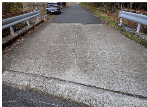
写真-8 舗装のひびわれ
