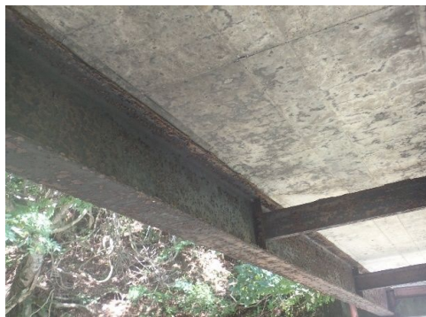
写真-2 鋼桁の塗装劣化
