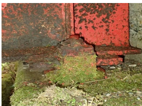
写真-3 支承の腐食
