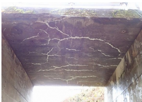
写真-5 RC橋 床版ひびわれ
