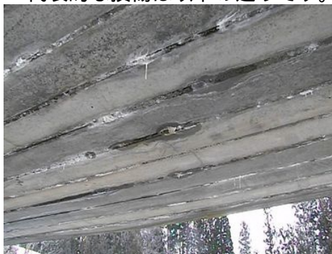
写真-1 PC橋主桁間詰部からの遊離石灰
