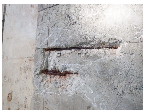
写真-6 下部工の剥離・鉄筋露出
