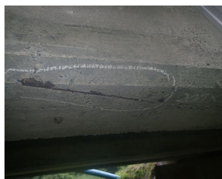
写真-4 RC橋 主桁の鉄筋露出
