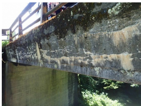
写真-7 地覆ひびわれ
