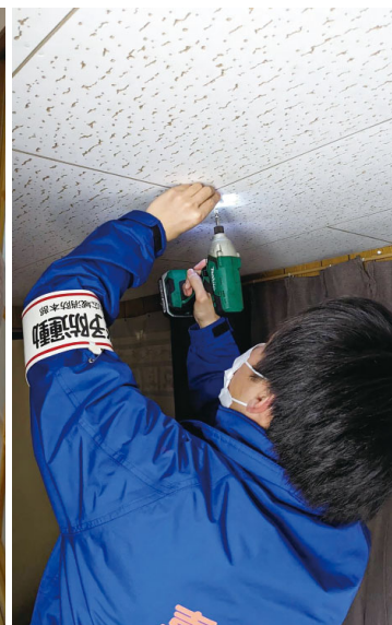
▲ 住宅用火災警報器を設置しました
