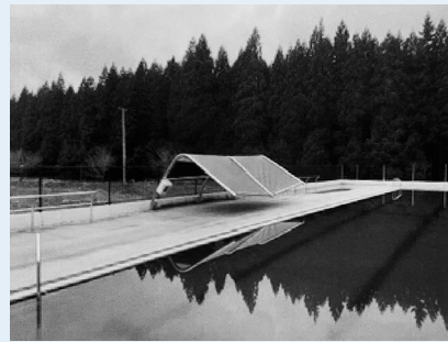
大雪の影響で壊れた 小学校プールの日よけテント
