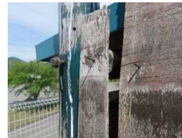
カート置き場 板張りの劣化、ボルトの緩み
