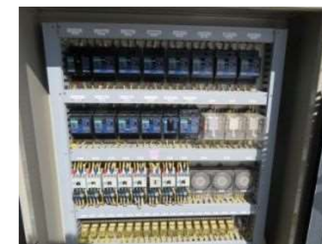
南トイレ(浄化槽) 機器故障中
