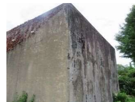
電気設備小屋A 外壁のジャンカの露出
