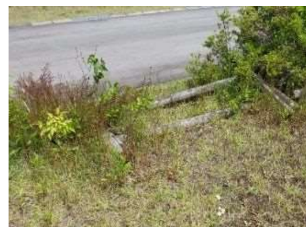
柵(ゴルフ場) 倒壊
