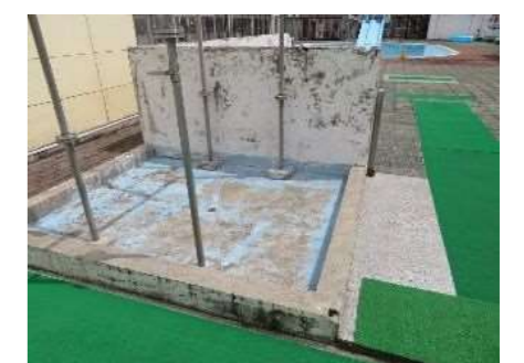
屋外プール(50m) コンクリートのひび割れ
