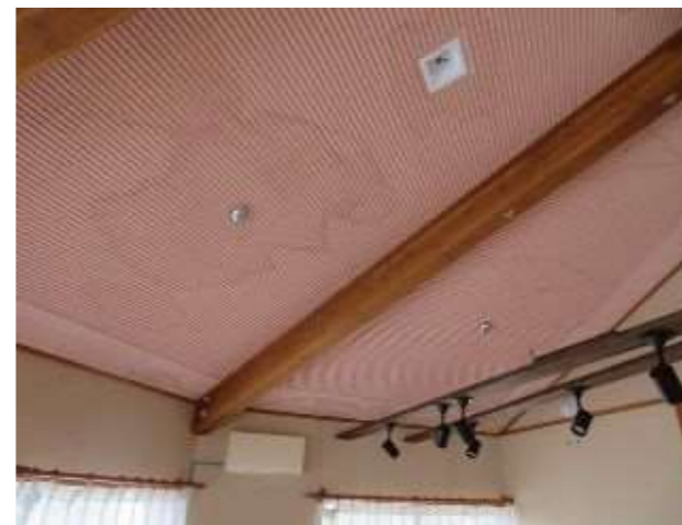
フレンズワールド管理棟(建物) 天井の雨漏り痕
