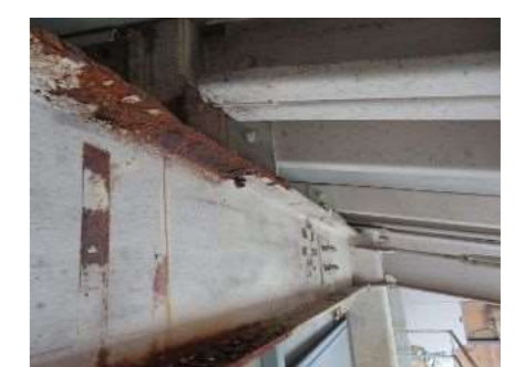
バックスクリーン 梁の腐食、断面欠損
