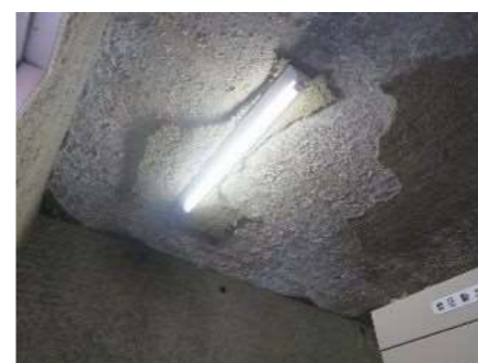
電気設備小屋C 吹付断熱材の剥落
