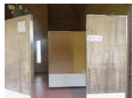
便所D 合板の剥離
