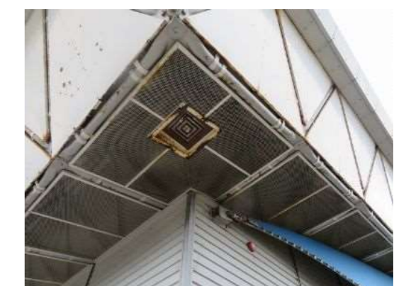
すぱーく西会津(建物) 軒先構造材の発錆・塗装剥離
