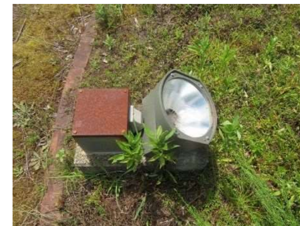
カリヨン(電気設備) 照明器具の腐食
