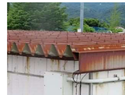
機械室小屋 屋根の錆
