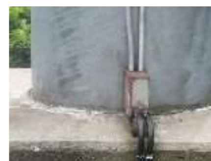
野球場屋外照明灯 シーリング切れ
