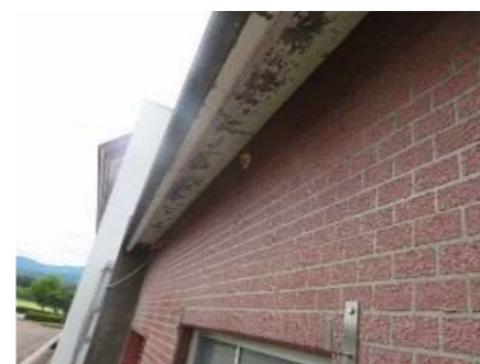
管理棟 軒裏のひび割れ
