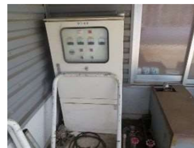
すぱーく西会津(浄化槽) 扉の錠の故障 ※車止めで仮押さえ
