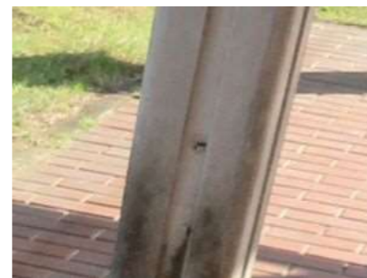
パーゴラC 鉄筋の爆裂
