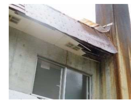
屋内プール 軒裏の剥落
