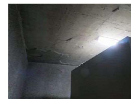
電気設備小屋B 吹付断熱材の剥落
