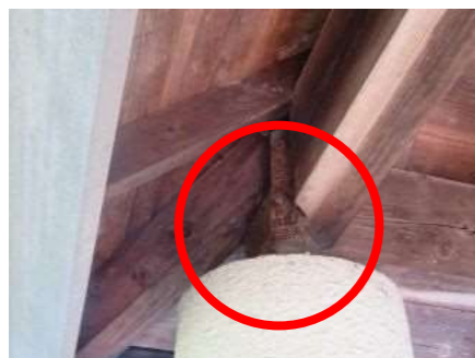
便所A 金物の腐食
