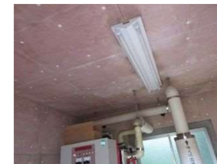
消火ポンプ室小屋 漏水痕
