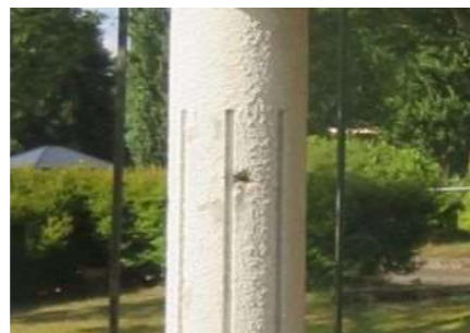
あづま屋C 鉄筋の爆裂
