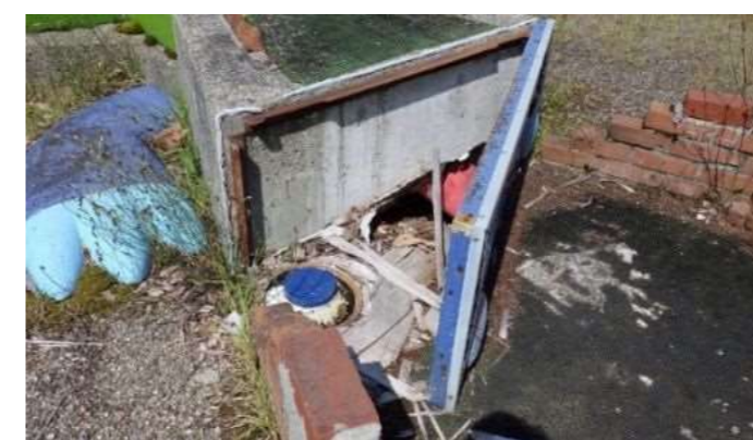
ミルトンミニチュアゴルフ場 付属物の破損
