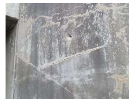
野球場スタンド 外壁ひび割れ、水の浸透痕
