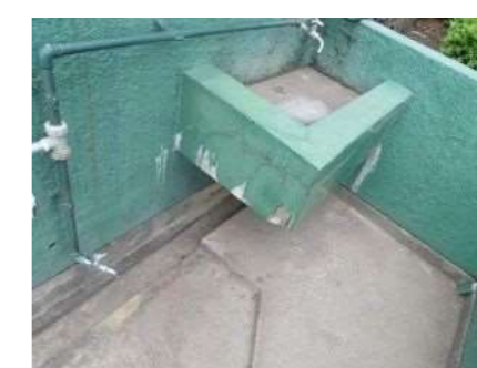
野球場ダッグアウト ひび割れ、モルタル剥落
