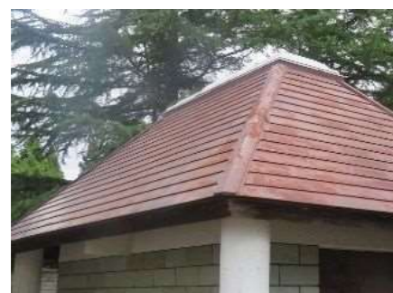
便所C 屋根の錆
