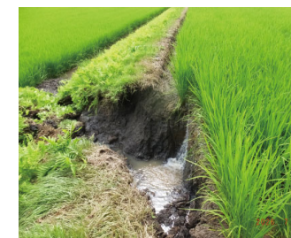
水田の法面崩壊
