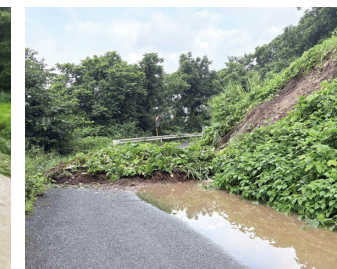
道路路肩の土砂崩れ
