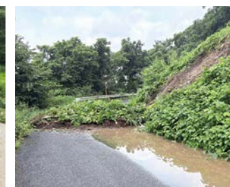
道路路肩の土砂崩れ
