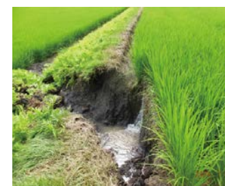
水田の法面崩壊
