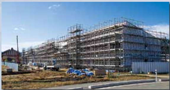
▲ 足場を設置し工事が進められた新校舎。左奥が西会津中学校(昨年10月15日撮影)
