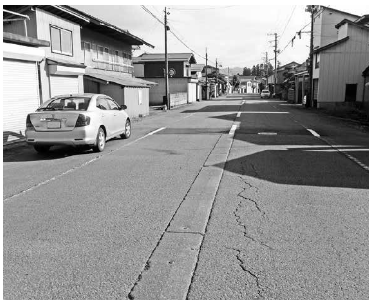
消雪施設の整備が待たれる（上野尻地区）
