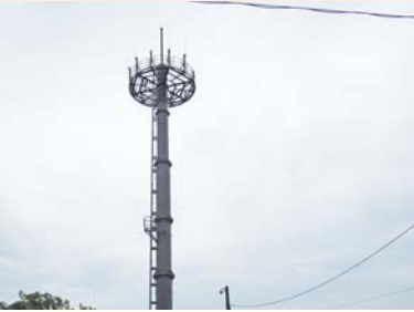
非常用電源設置済みの荒木中継局の防災行政無線
