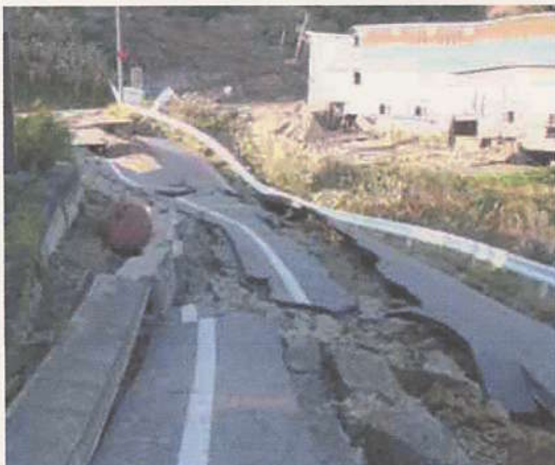
平成16年新潟県中越地震旧山古志村（喜多方広域消防本部撮影） 道路の寸断により被災地では多くの地区が孤立しました
