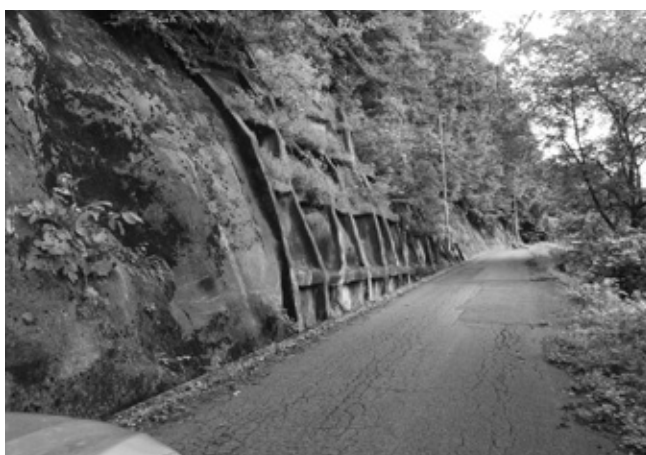
崖崩れ、土砂災害などが心配される道路
