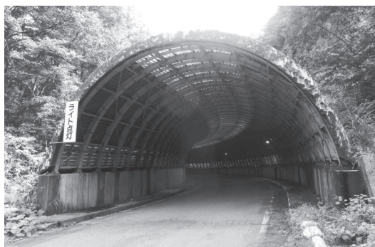
白坂スノーシェッドの状況
