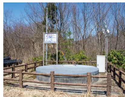
▲ 下沢の目地区の集水井
